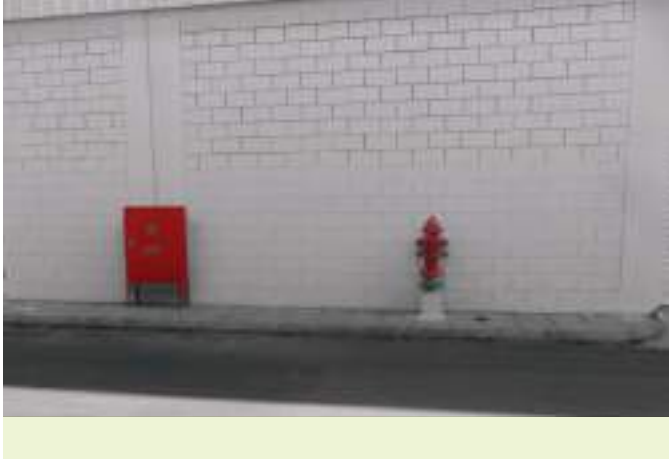
مدينة جدة الصناعية مأخذ مياه إطفاء الحريق الخارجية
